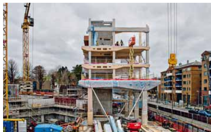
Der Empfangsbereich im rechten Gebäudeflügel reicht stützenfrei über zwei Geschosse. Buche-FSH-Stützen und -Träger nehmen die von oben kumulierenden Kräfte auch ohne Mittelstütze auf. (Foto: Spare-Bank1 SR-Bank)
