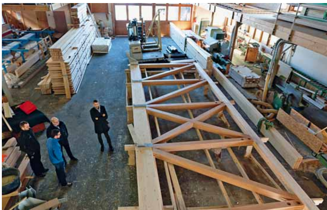
Werkseitige Vorfertigung der Fachwerkträger aus Fichten-Brettschichtholz (Gurte) und „Baubuche“ (Pfosten und Diagonalen). (Foto: Helber+Ruff)
